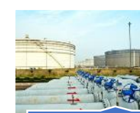
Резервуары для хранения
