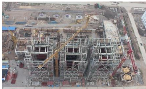
Когенерационная электростанция в Уханьском этиленовом проекте
